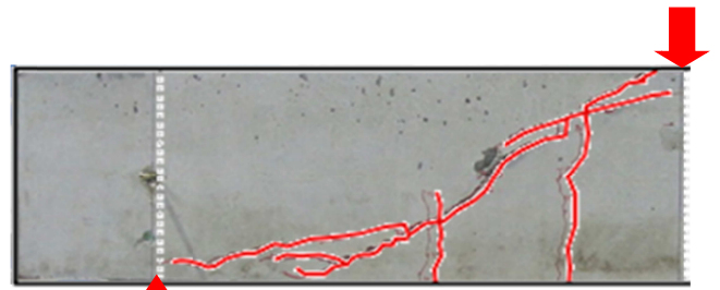
図-3(a) N-0-R 供試体ひび割れ図
