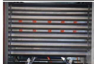
図16 下水流下前 清浄時熱交換面の様子
