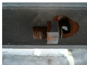
(ii) ボルト破断
