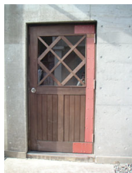
写真2：修理されたドア
