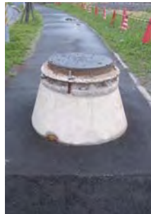
液状化によるマンホールの浮上
